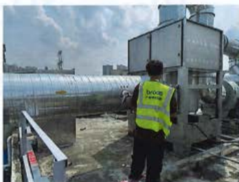
DA003 废气处理前采样口 2#
