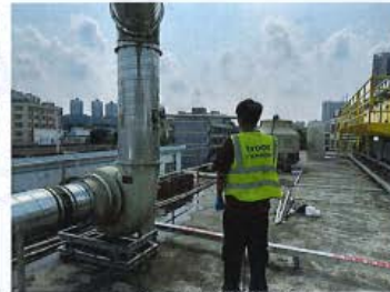
DA003 废气处理前采样口 1#
