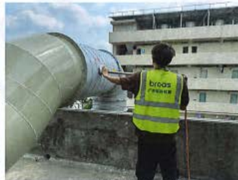
DA007 废气处理前采样口
