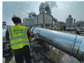
DA003 废气处理前采样口 4#
