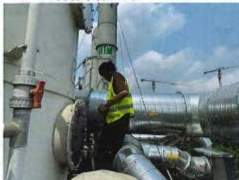
DA006 废气处理前采样口
