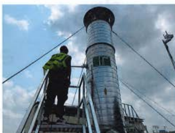
DA006 废气处理后采样口
