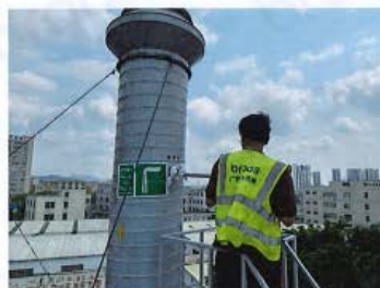
DA007 废气处理后采样口
