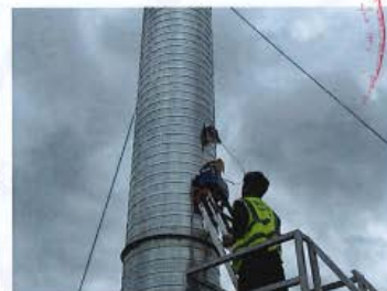
DA003 废气处理后采样口
