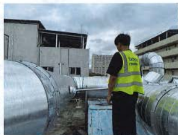
DA003 废气处理前采样口 3#
